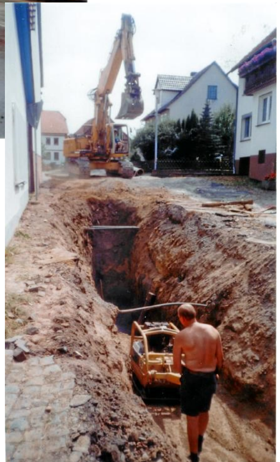
Rechts: Ein Foto über das Ausmaß der Kanalisationsarbeiten in der Straße „Hornberger Weg“ vor den Anwesen Grunewald und Stegemann. Ein Arbeiter der Firma Franke verdichtet mit Sand die in 3,80 Meter Tiefe gelegten dicken Rohre.
