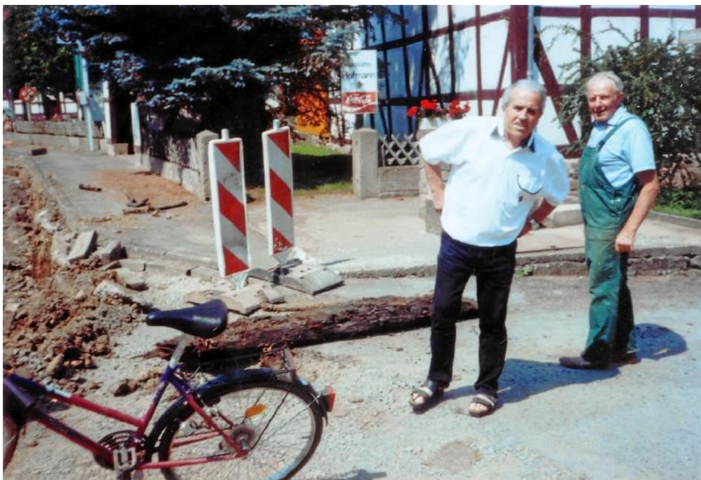
Durch den Bagger aus dem Erdreich gehoben: Eine ca. 180 Jahre alte Wasserleitung aus Holz: H. Kellner nahm sie in sein Museum auf (siehe hinter K. Ploch liegend.)
