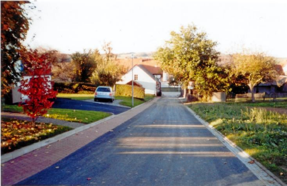
Die fertig ausgebaute Straße „Zum Hügelskopf“, Höhe Haus Hofmann/Fröhlich. Diese Straße hatte die Neubearbeitung nötig. Hier war alles marode. Die Zeit hatte am Zustand besonders Spuren hinterlassen.
