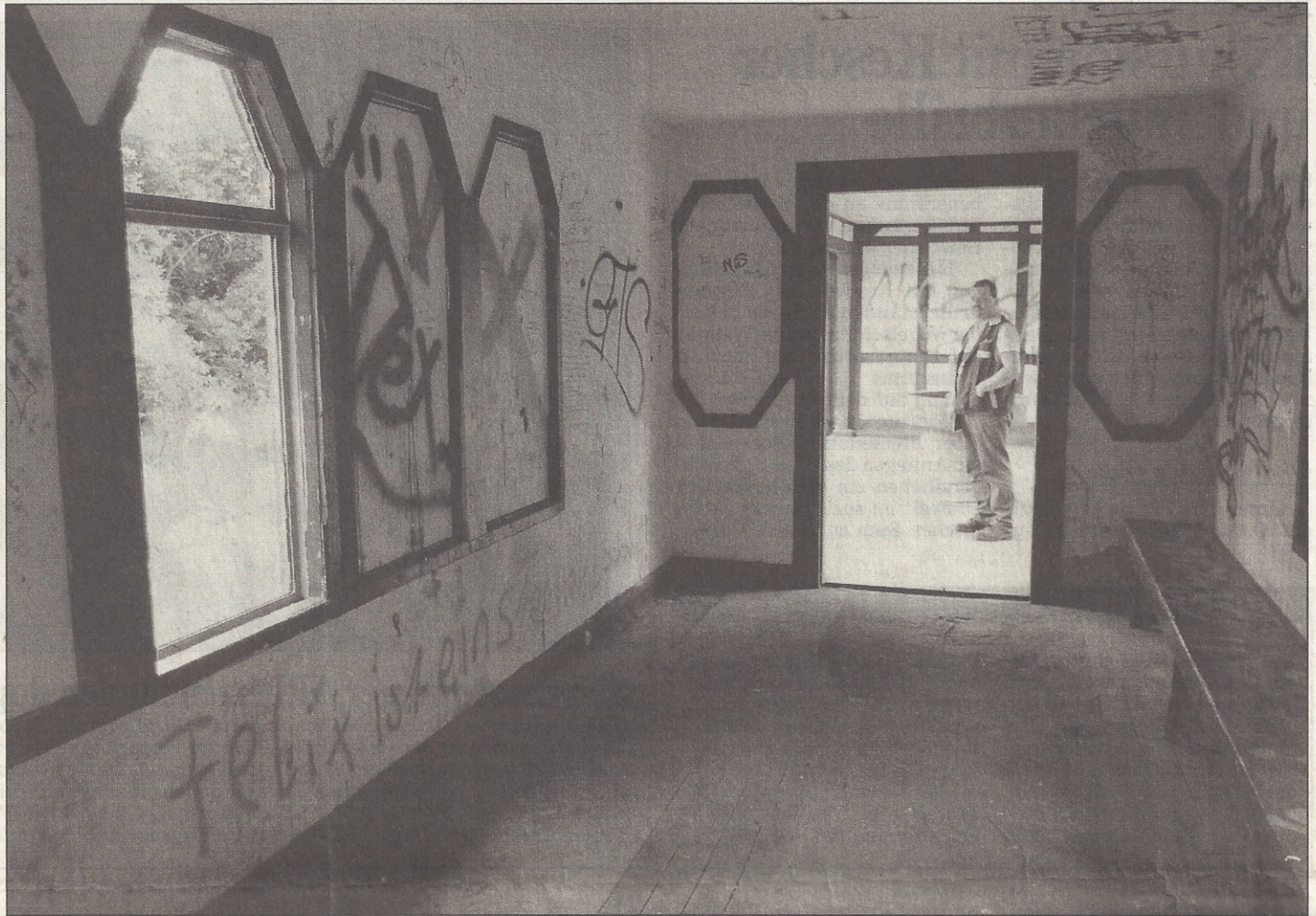
Wahrlich keinen einladenden Eindruck macht der Malsfelder Bahnhof. Berufspendler wie dieser beobachten von Woche zu Woche neue Schmierereien an Außen- und Innenwänden. Vor nicht allzu langer Zeit seien die Wände geweißt worden, erinnerte sich dieser Arbeiter der Firma Linß, der täglich mit dem Zug fährt. (Foto: Brückmann)
