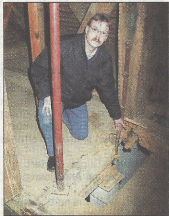
Schaden unterm Dach: Bauleiter und Architekt Christian Wieder-Gellersen zeigt ein großes Loch im Dachboden.
