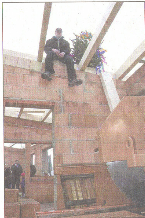
Stellte den Richtkranz auf: Handwerker Kevin Kurzrock auf dem Dachstuhl des Rohbaus.
