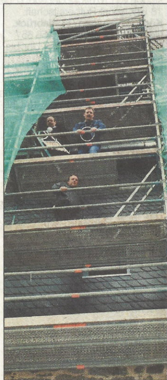
Weg nach oben: Die neue Turmzier wird auf den Turm gebracht. oben links Klaus Henkel und Bauleiter Christian Wieder-Gellersen, unten Hans Joachim Hocke
